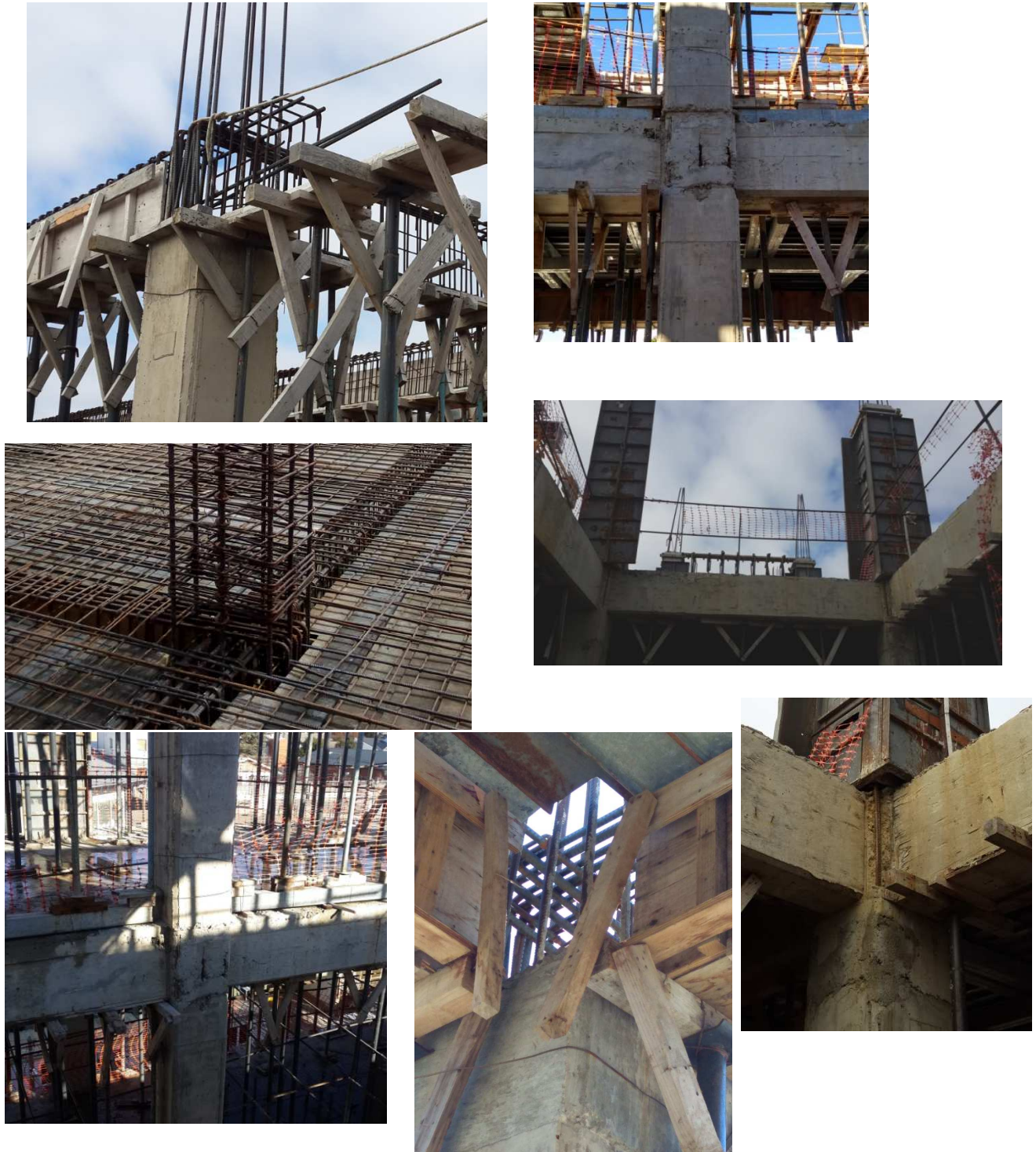
Fig. 52. Fotos tomadas en obra donde se aprecia la falta de estribos en los nudos.
