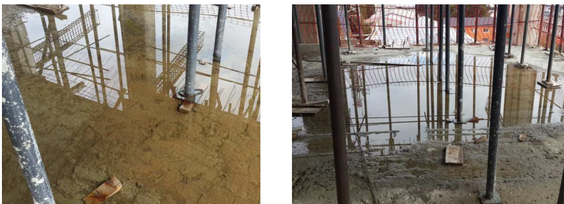
Fig. 55. Acumulación de agua en las losas.
